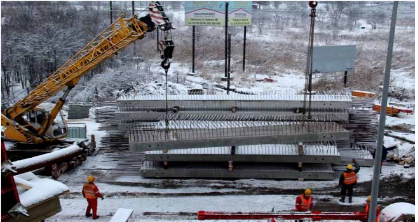
Plac budowy. W lutym do Chrzanowa dojechały elementy, z których powstanie łuk nad wiaduktem
